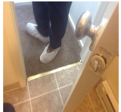
54 05-A Unit 03 Bathroom 1 - Door - Entry/Fire/Bath
