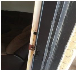
5 604 Unit 604-09 Entire Unit - Front Door/Door Jamb
